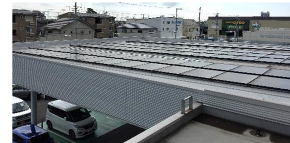
販売店舗へのソーラーパネル設置
