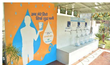
設置された飲料水サーバー
