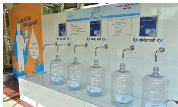
設置された飲料水サーバー
