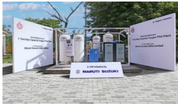
当社が設置した酸素発生装置
