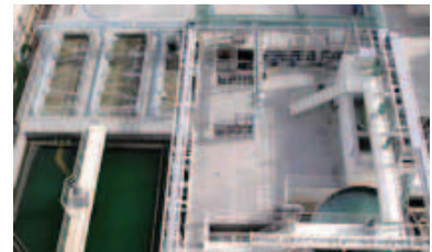
2007年6月に増設・稼働開始した排水処理設備
