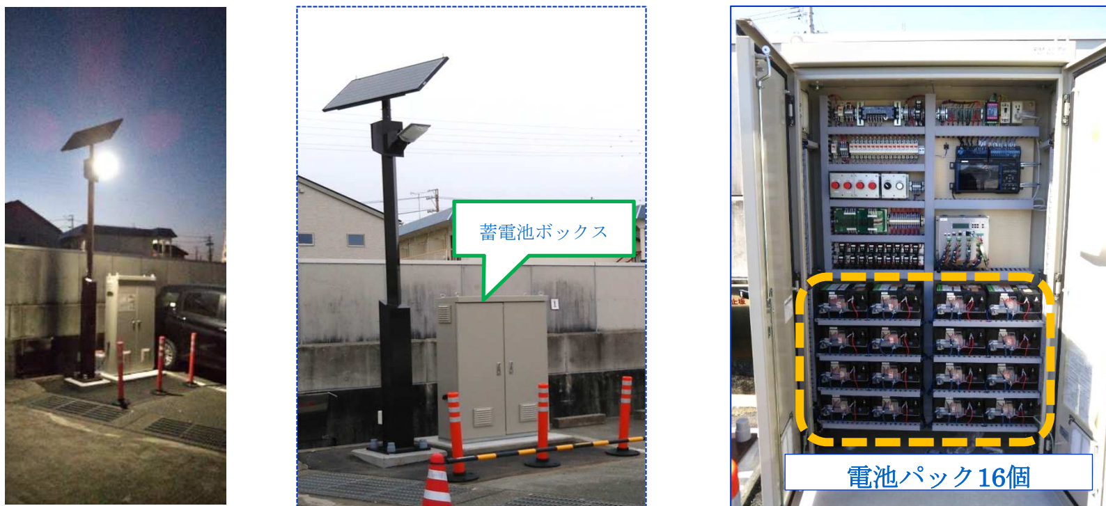
図1 設置したソーラー街灯と蓄電池ボックスの内部
