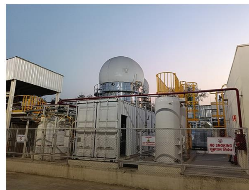
マネサール工場に設置したバイオガスプラント
