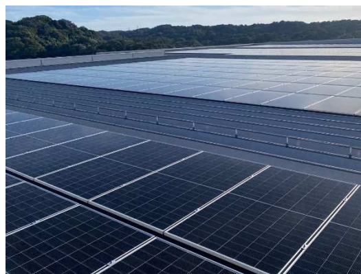
屋根上に設置した太陽光パネル
