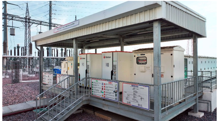
バッテリーエネルギー貯蔵システム
