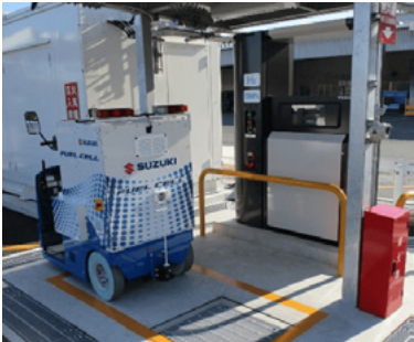
湖西工場の水素充填設備
